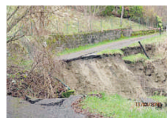
COLI - La strada erosa da un movimento franoso nella frazione Ruei
